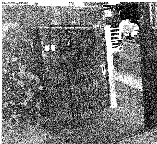
Figura 2-6 – Quadro de distribuição a ser substituído.
